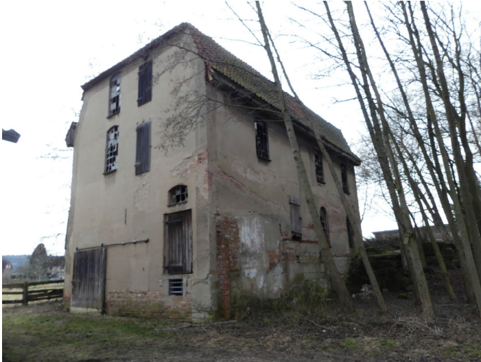
Abb. 220: Heutiger Zustand der ehemaligen Warnneck'schen Mühle in Neuhof, N 51° 58' 50.25", O 10° 2' 5.20"; Aufnahme vom 05.03.2018.
